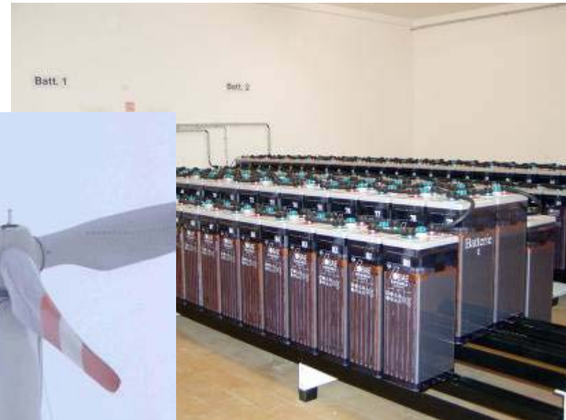
Akku-Raum im Umspannwerk
